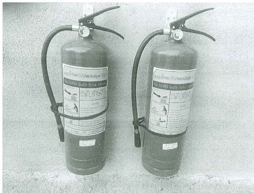
Hình 3.20. Thiết bị chữa cháy cầm tay
